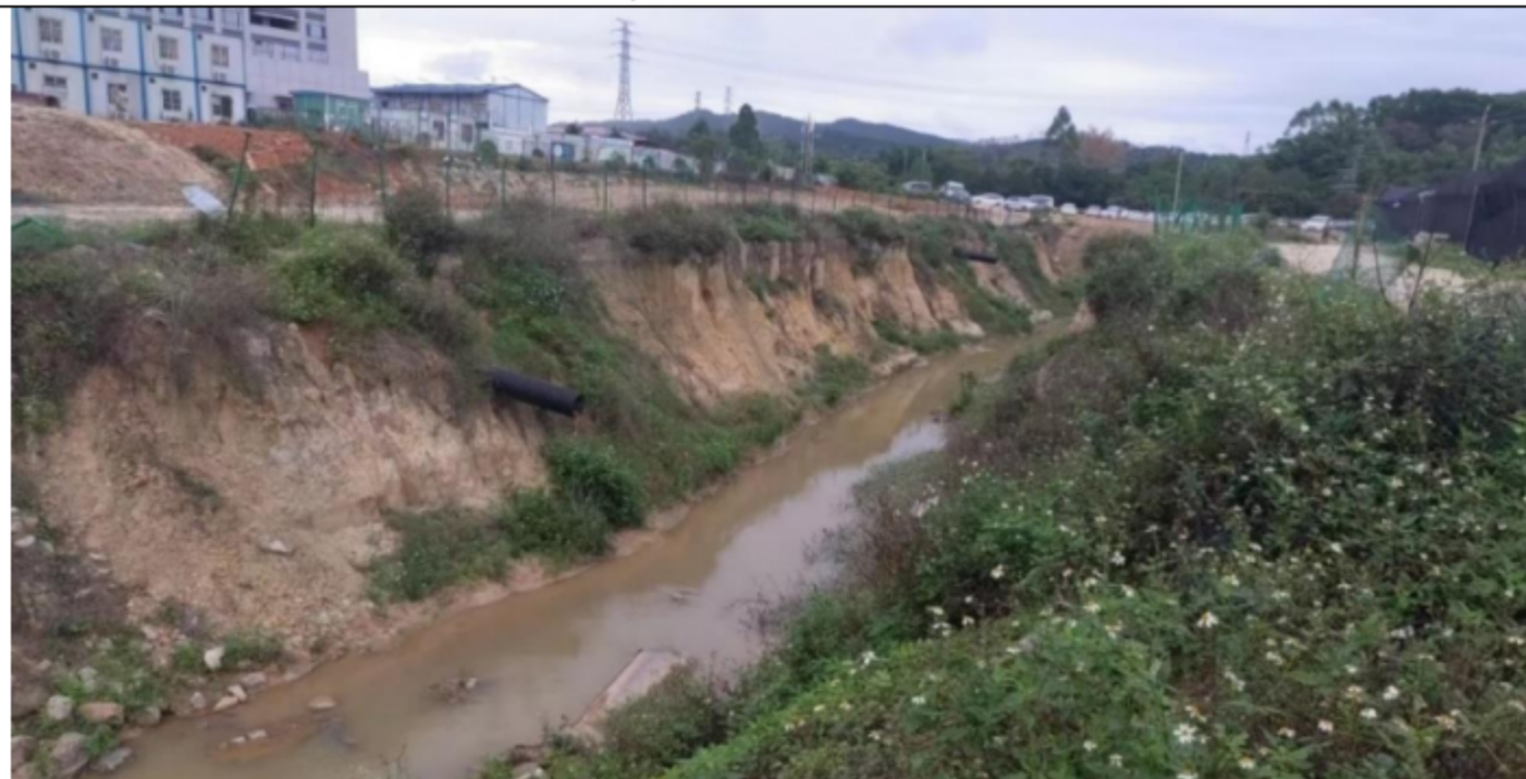
响水河玉湖地块剩余未实施段土渠边缘坍塌
