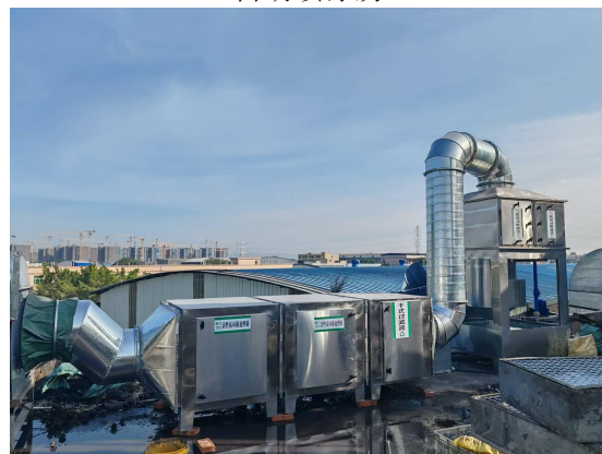
废气处理设施-TA002（水喷淋+干式过滤器+二级活性炭吸附）
