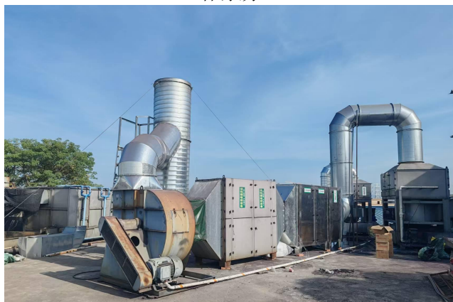
废气处理设施-TA001（水喷淋+干式过滤器+二级活性炭吸附）
