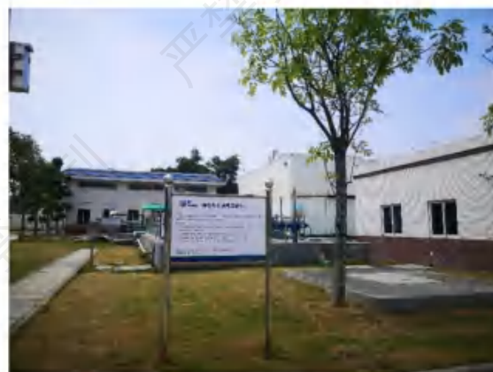
细格栅及曝气沉砂池
