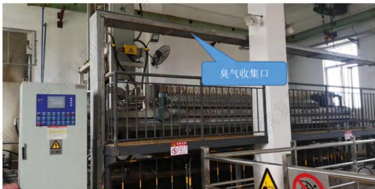
图 2.3.2-1 污泥干化车间板框压滤机臭气收集情况
