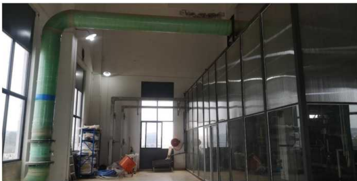
板框压滤机臭气收集
