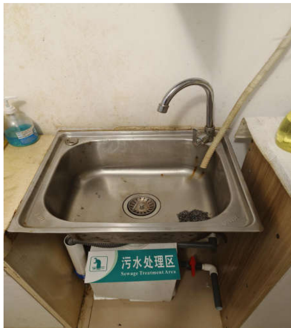
项目医疗废水处理装置
